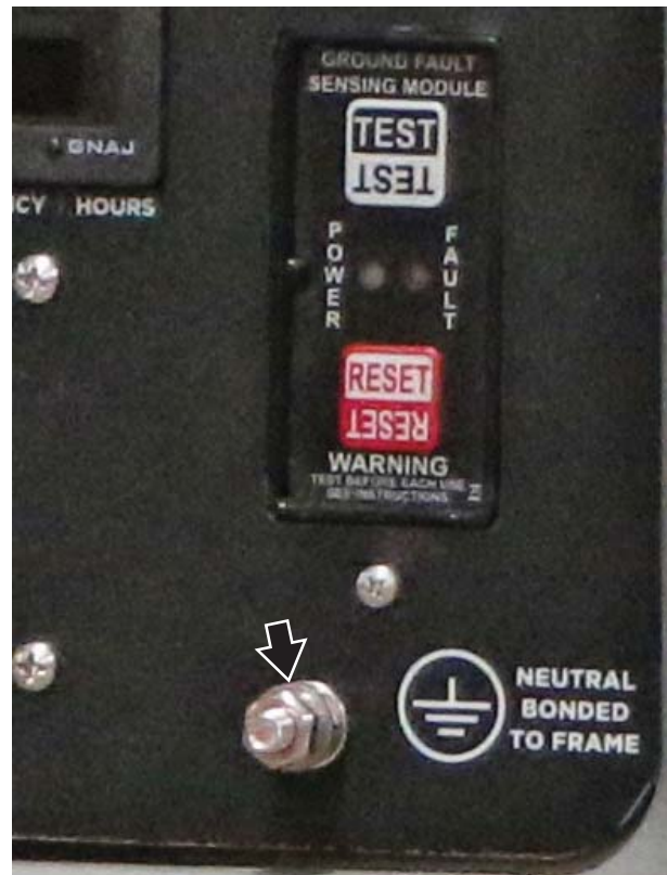
Figura 16 – Terminal de conexión a tierra del panel de control
