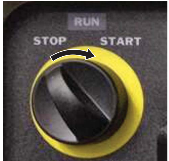
Figura 28 – Interruptor de control del motor
